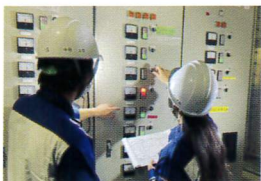
電気設備点検
